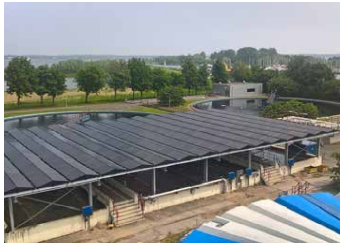
Zonnepanelen op rioolwaterzuivering
